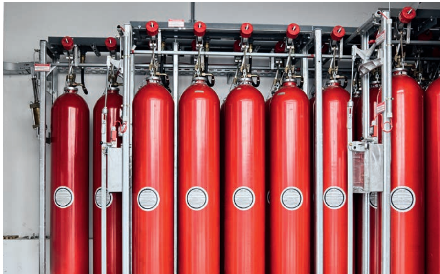
Die Argonlöschanlage der Räume der Hauptspannungsversorgung des Werkes löst nur aus, wenn zwei unterschiedliche und voneinander getrennte Meldeeinrichtungen Alarm geben: manuelle Druckknopfmelder, Rauchmelder an der Decke, Rauchmelder im Boden und ein Rauchansaugsystem.
