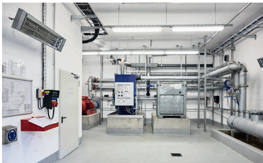
Vom Sprinklergebäude aus wird die vollautomatische Sprinkleranlage in der Presserei gesteuert. Verschiedene Kreisläufe und Versorgungseinheiten stellen sicher, dass der Wasserfluss immer funktioniert.
