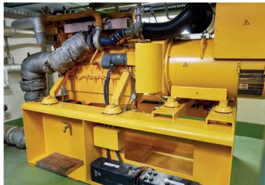
Kleingewerbliches BHKW mit verkleideter Verrohrung
