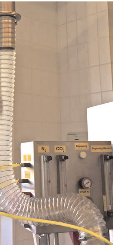
Die flexiblen Absaugschläuche sind an feste Verrohrungen angeschlossen. Durch sie gelangt das abgesaugte Gasgemisch zur Abluftanlage.
