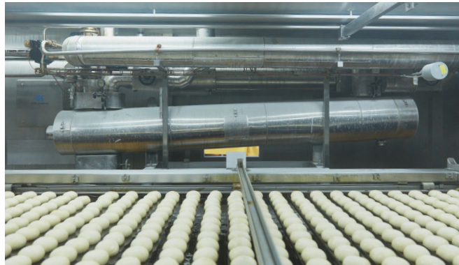
Das Erhitzen des Frittieröls erfolgt indirekt mittels Wämetauscher (im Hintergrund). Die Frittieröltemperatur in der Fettbackwanne wird so immer zwischen 165 und 173 °C gehalten.
