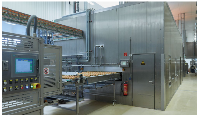
Feuerhemmende Einhausung der Fettbackanlage
