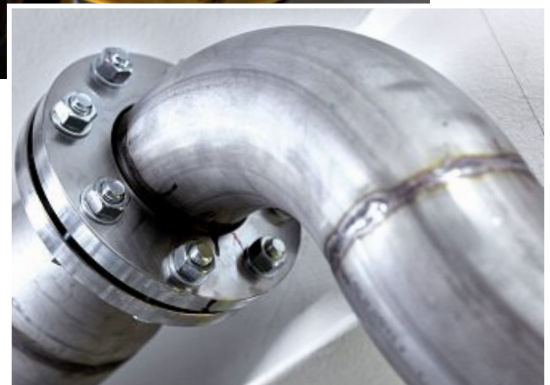
Aufgrund von Dauerbelastung durch Vibrationen sowie durch Druck- und Temperaturschwankungen können Leitungsabschlüsse undicht werden und/oder Risse entstehen.
