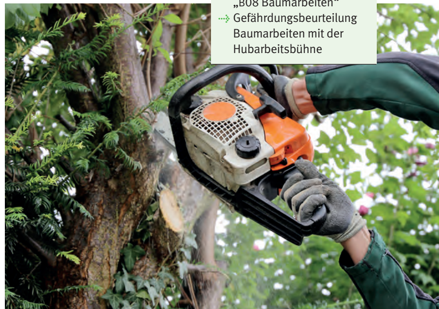
Überkopparbeiten mit der Motorsäge sind verboten.
