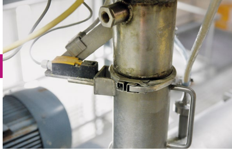
Mit Positionsschalter gesicherte Revisionsöffnung
