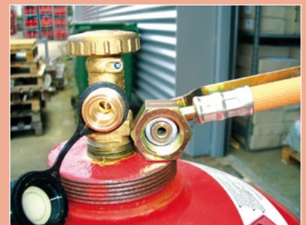
Großflaschenanlage mit Hochdruckschlauch
