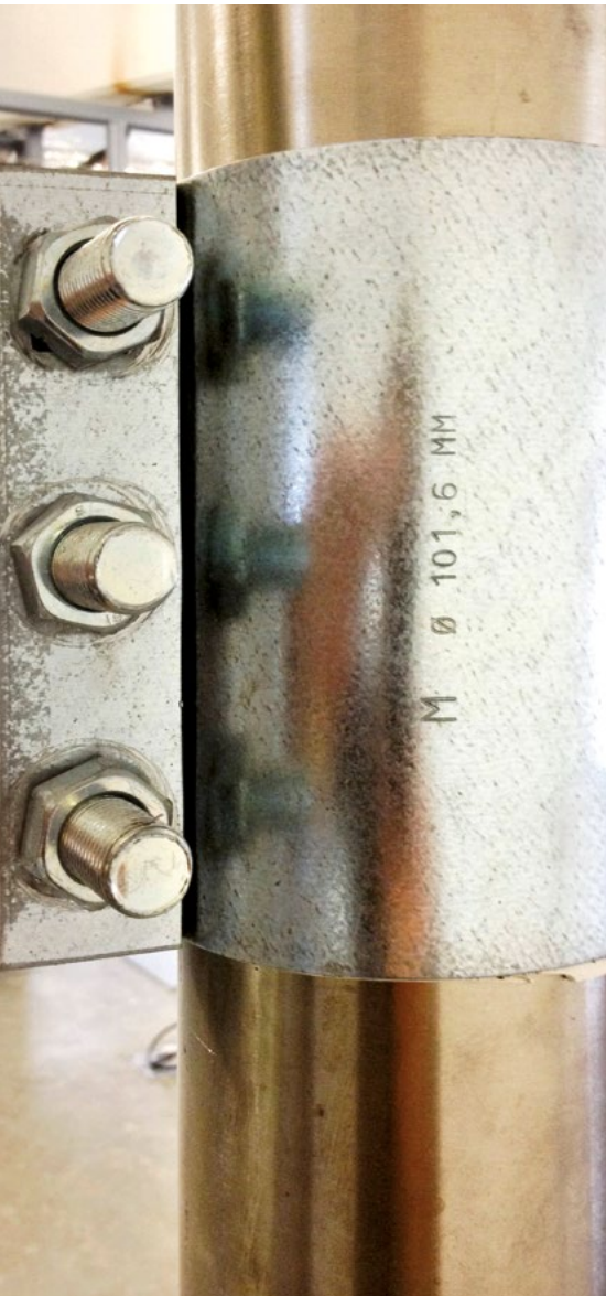
Rohrmanschetten brauchen besondere Sicherung.
