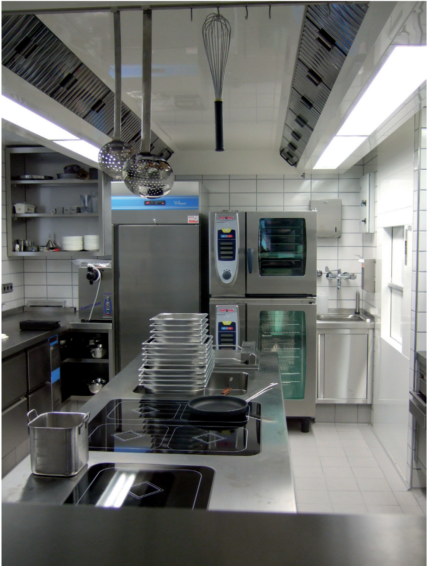
Abb. 4: Absaugung zur Abführung von Wrasen und Dünsten über Kücheneinrichtungen
