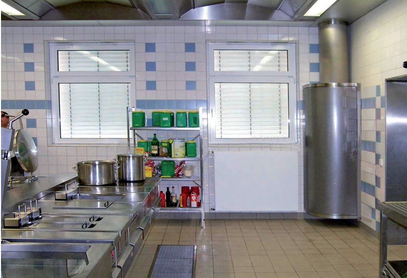
Abb. 14: Der Quellluftdurchlass (Viertelzylinder) in der Ecke ist über dem Fußboden positioniert. Dadurch ist eine leichte Reinigung unter dem Auslass möglich.
