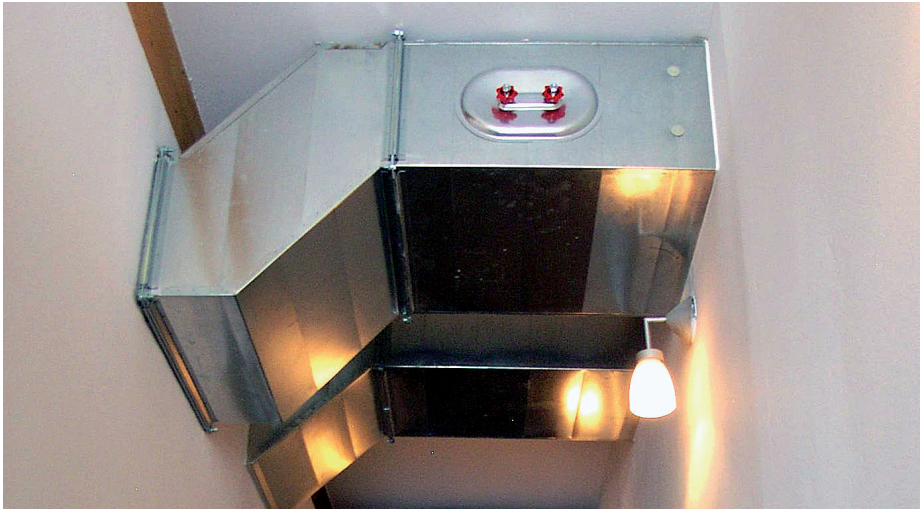
Abb. 21: Luftleitung mit Revisionsöffnung zur Innenkontrolle der Leitung
