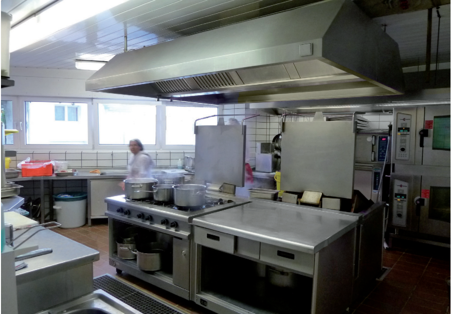
Abb. 9: Korrekt angebrachte Küchenlüftungshaube
