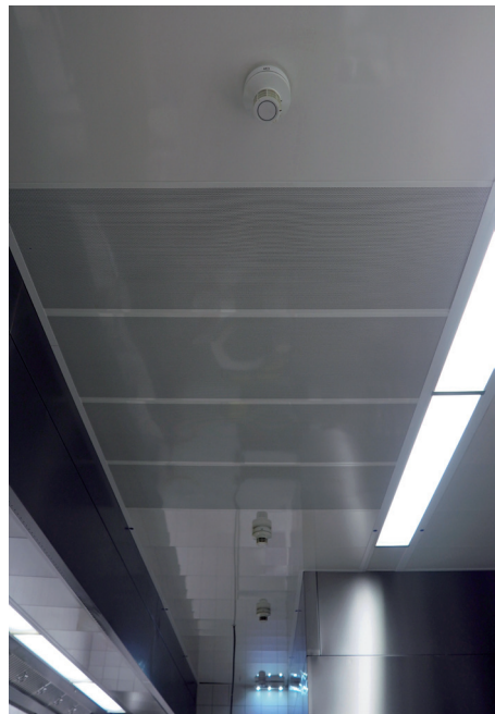
Abb. 18: In eine Küchendecke integrierter Verdrängungsluftdurchlass.
