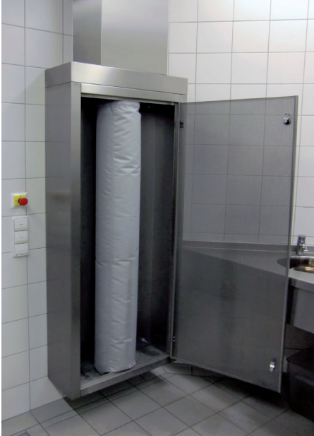
Abb. 17: Textiler Luftsack zur gleichmäßigen Verteilung der Zuluft.
