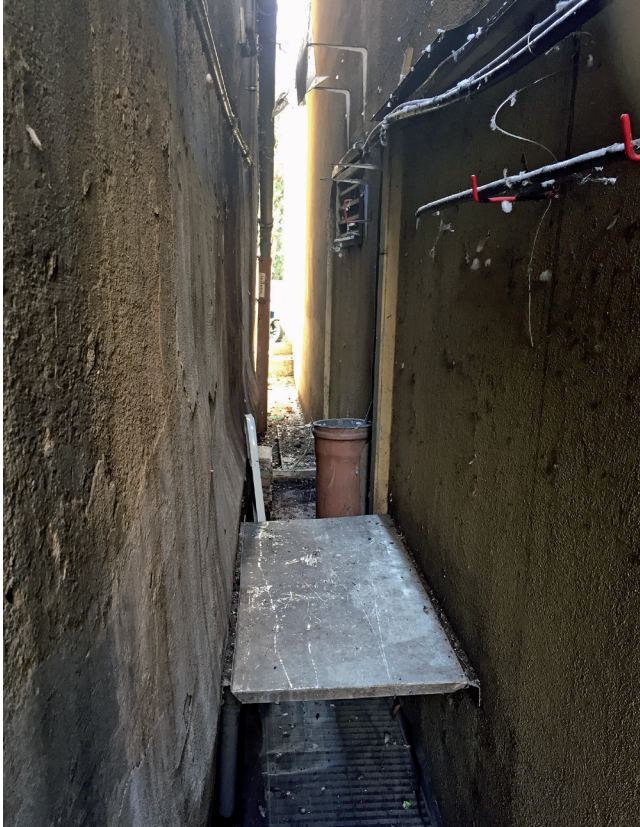
Abb. 22: Stark verschmutzte und hygienisch inakzeptable Situation Zuluftansaugung im Bodenbereich.
