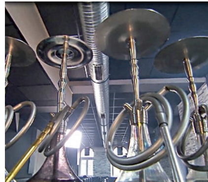
Gastraum mit Lüftungsanlage © SWR
